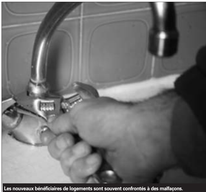
Les nouveaux bénéficiaires de logements sont souvent confrontés à des malfaçons.
