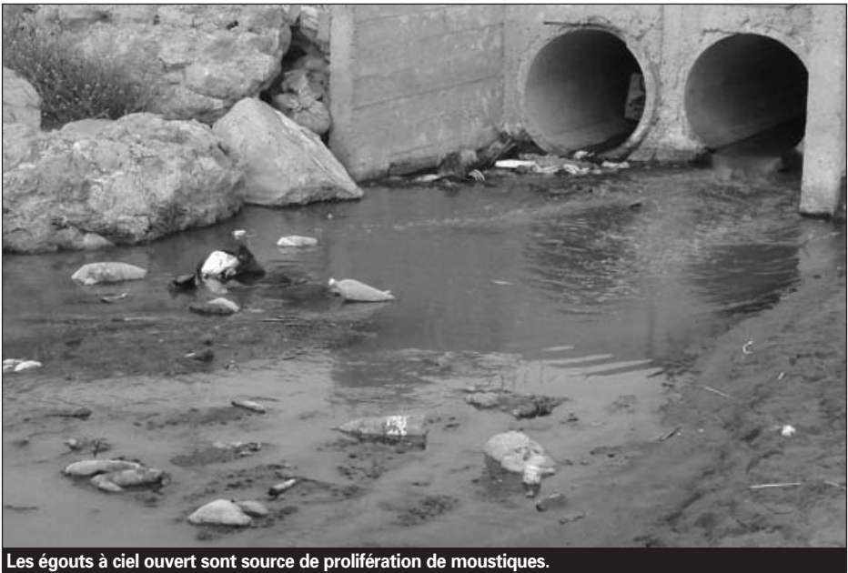
Les égouts à ciel ouvert sont source de prolifération de moustiques.
